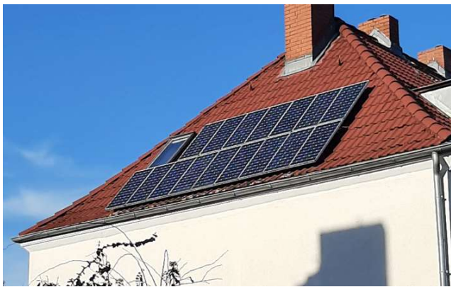
PV-Anlage auf einem Walmdach
