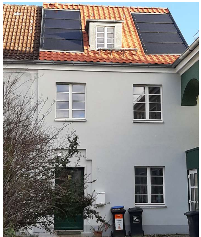
Eine der wenigen dachintegrierten PV-Anlagen
