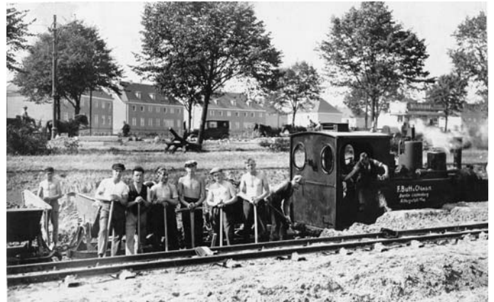
Ausschubarbeiten für den U-Bahn-Tunnel zwischen Station Flughafen und Tempelhof, hinten Berliner Straße, 1926
